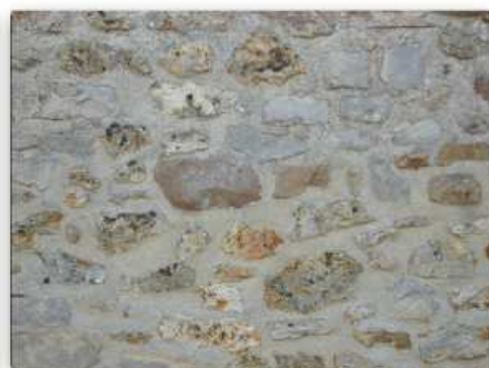
Enduit à pierre-vue par rejointoiment à l'enduit chaulé Faible couverture de la pierre
