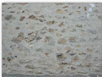
Enduit à pierre-vue par beurrage à l'enduit chaulé Faible couverture de la pierre
