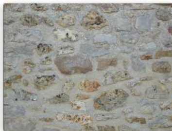
Enduit à pierre-vue par rejointoiement à l'enduit chaulé Faible couverture de la pierre
