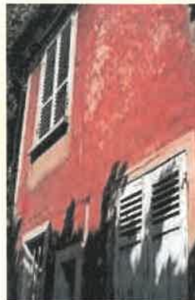
Ponctuellement, on rencontre des enduits très vifs. ▼
